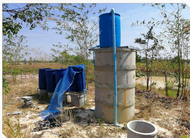
ระบบกรองน้ำด้วยระบบชีวภาพ
