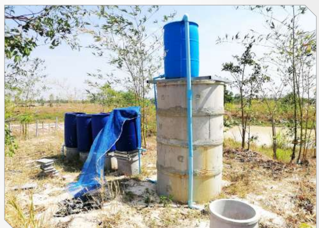
ระบบกรองน้ำด้วยระบบชีวภาพ
